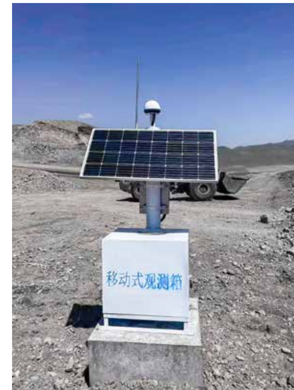
▲移动式观测箱中海达 GNSS 边坡监测站
